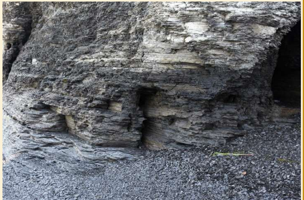
L'érosion à Pointe -Platon. Photo : Rock Giguère
